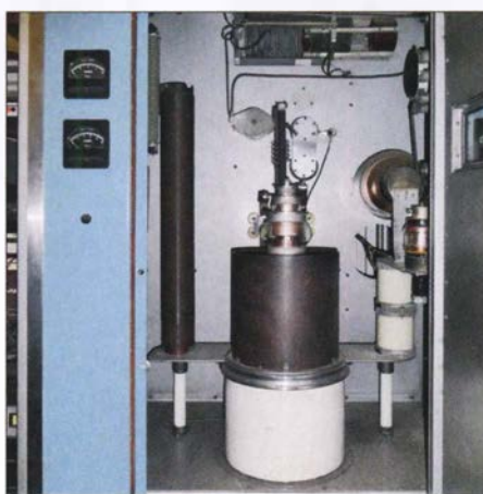
Eine der 25-kW-Endstufen
